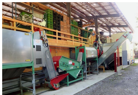
Die Anlage der Nuss Thurgau AG in Hörhausen besteht aus Waschmaschine (rechts), Steinseparator (Mitte), und Wasch- und Enthüllungsmaschine (rechts).
