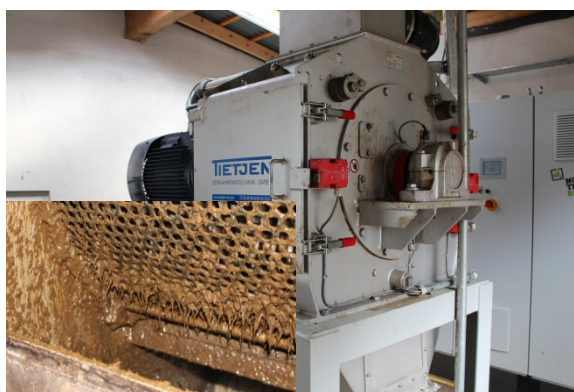
Figur 22: For mellemstore og store biogasanlæg kan forbehandlingsteknikker som denne kombinationen af hammermølle og specielle mikroorganisme forbedre effektivitet og stabilitet. Foto: F. Gerlach, FiBL.
