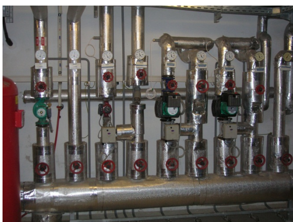
Figur 23: Varmedistribution i biogasanlægget. Professionelle koncepter kan udnytte en stor del af varmeproduktionen. Foto: MEP.
