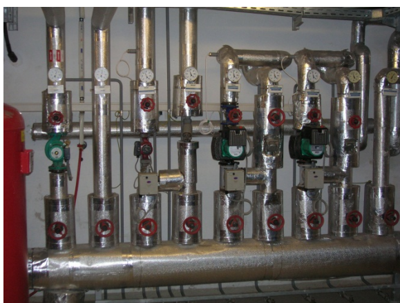
Rys. 23: Dystrybutor ciepła w biogazowni. Dzięki profesjonalnym rozwiązaniom można wykorzystywać sporą część wytworzonego ciepła. Zdjęcie: MEP.
