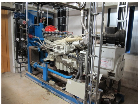
Rys. 29: CHP: Biogaz dla energii elektrycznej i ciepła. Zdjęcie: V. Jaensch, RENAC.
