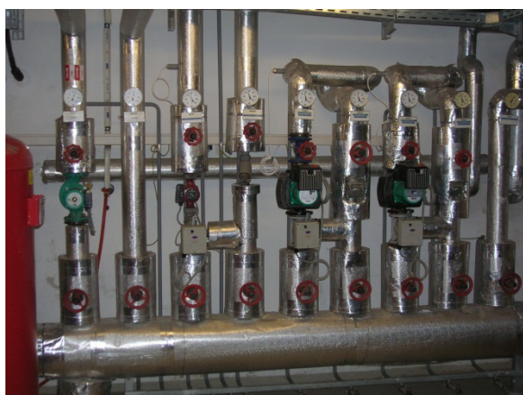
Figura 22: La distribución del calor en la planta de biogás. Conceptos profesionales pueden utilizar una gran parte del calor producido. Foto: MEP.
