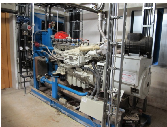
Figura 28: CHP: Biogás para electricidad y calor. Foto: V. Jaensch, RENAC.
