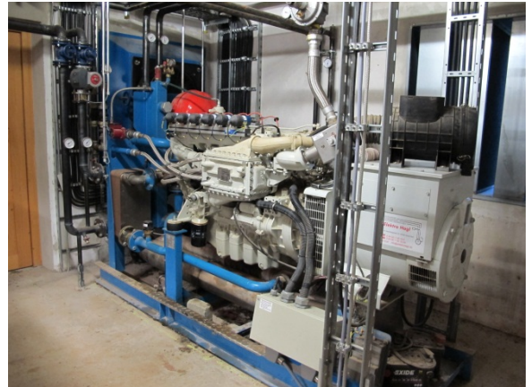
Abbildung 29: BHKW: Biogas für Strom und Wärme. Foto: V. Jaensch, RENAC.
