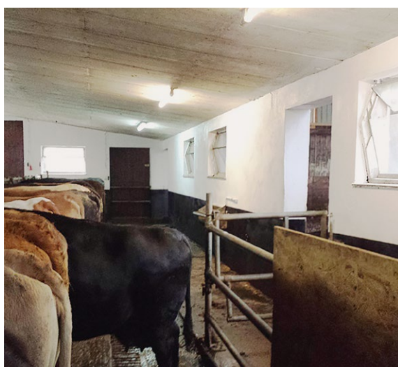
Le chaulage des murs et des plafonds permet d'améliorer l'hygiène dans les bâtiments d'élevage.
